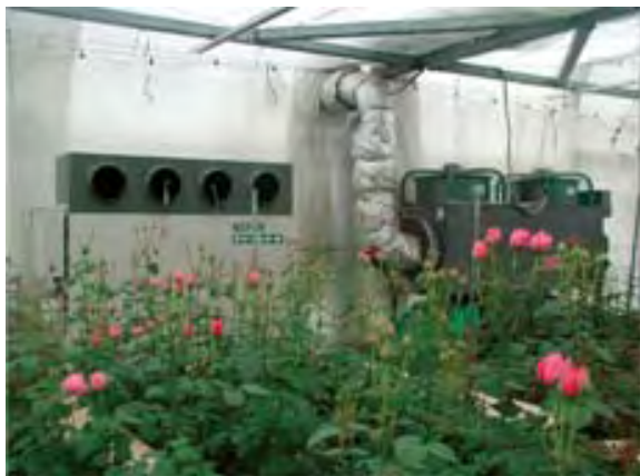
バラ栽培のためのヒートポンプによる加湿・冷却・除湿用装置
