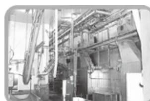
(蒸気湯引きトンネル)
