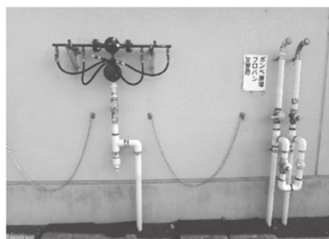
緊急時の LP ガス供給設備
