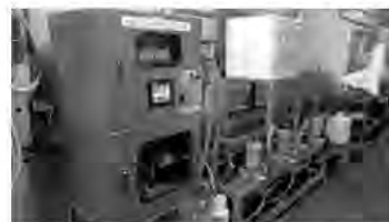
薬液濃度連続制御装置
